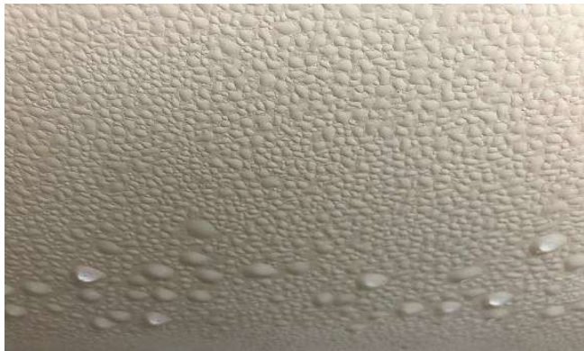
冷蔵庫の天井結露
